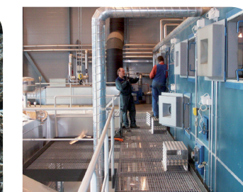
EDAR Haapavesi, Finlandia 1.500 tMS/año
